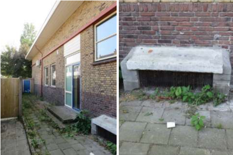
13 en 14 – Linker geveldeel linkerzijgevel van -bouwdeel B en detail koekoek met stalen ontluuchtingsrooster ten behoeve van de kelder
