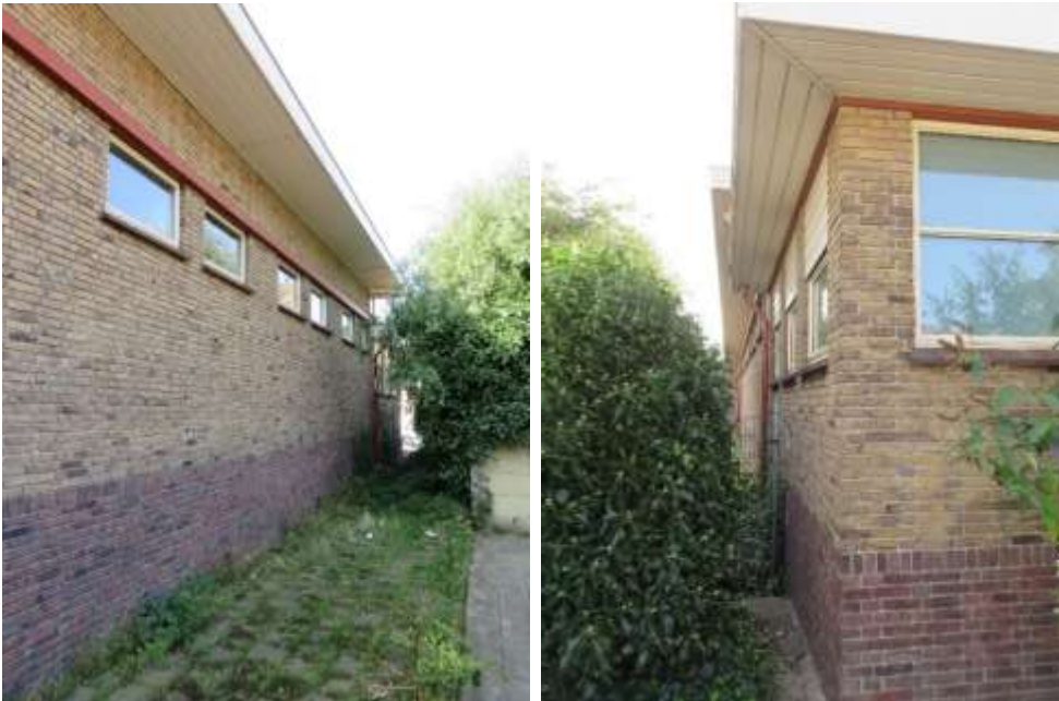
15 en 16 – Rechter geveldeel linkerzijgevel van bouwdeel B en detail hoek voorgevel en linkerzijgevel
