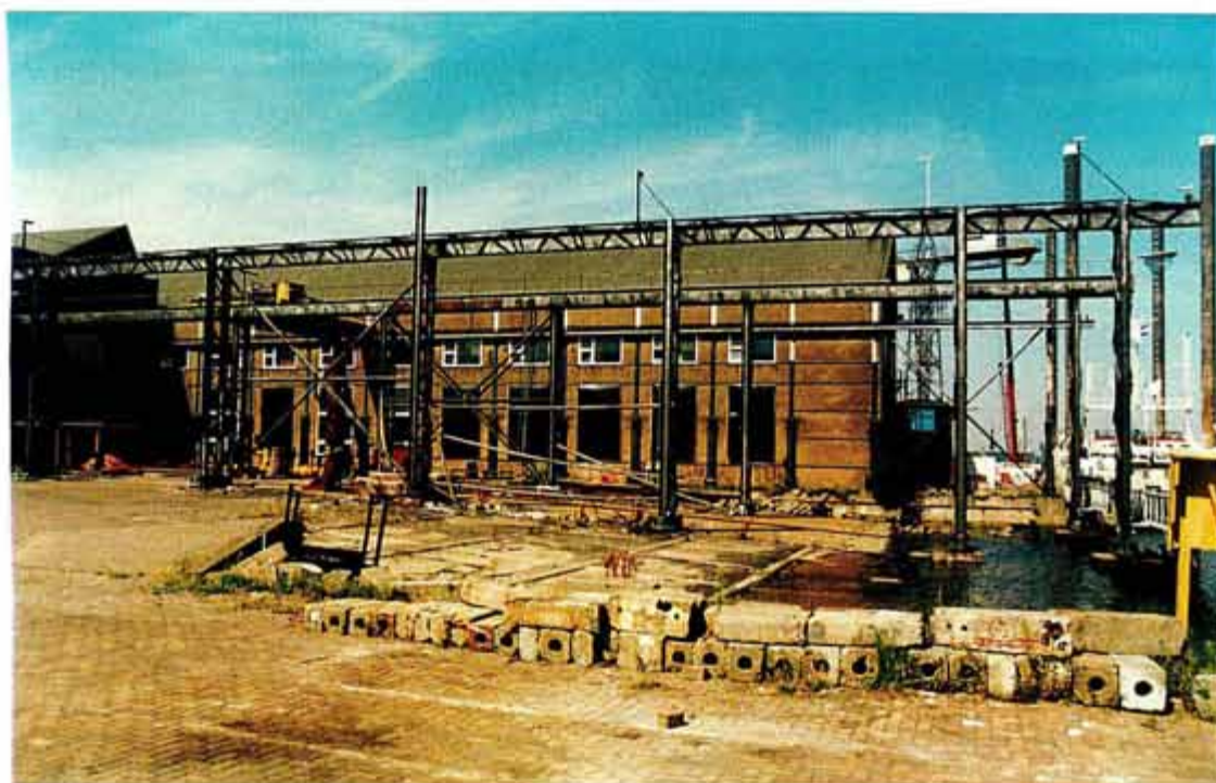
Afb. 9 (boven) Overzicht van gebouw 51, gezien vanuit het zuidwesten. Centraal op de foto is de scheepshelling met de bijbehorende kraanbaan uit 1948 zichtbaar. De lange eenbeukige hal rechts van de helling dateert uit 1950-'52. De twee sheddaken achter de helling horen bij de eerste fase van het gebouw en dateren uit 1938-'39.
