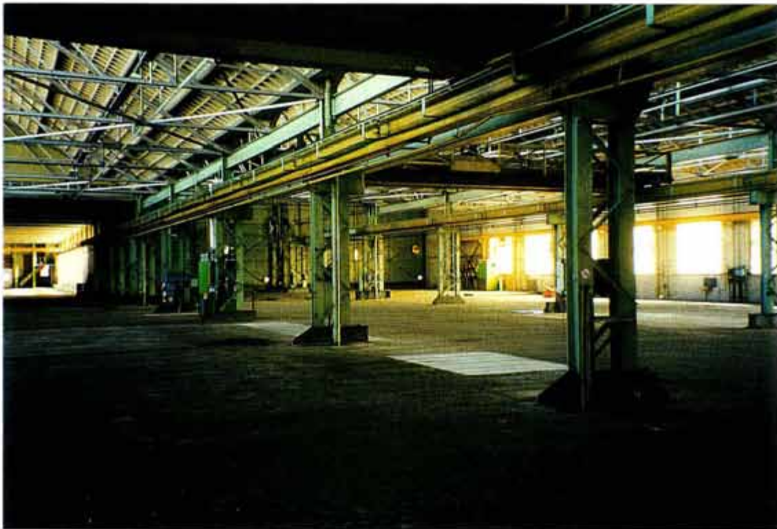
Afb. 16 Overzicht van de lage driebeukige hal van gebouw 51 uit 1938-'39, gezien naar het oosten. Als dragers van het staalskelet zijn tussen de drie beuken samengestelde, open kolommen toegepast. De sheddaken zijn aan de noordzijde voorzien van glaspanelen (thans kunststof) en aan de zuidzijde van bimsbetonnen cassetten. Aan de noordzijde sluit de korte hoge driebeukige hal op deze lage hal aan (afb. 19). De noordelijke beuk is langer dan de beide andere beuken, door de bouw van een eenbeukig gebouw in 1951-'52 (zie afb. 14 en 15). De beide andere beuken zijn afgesloten door in ca. 1948 aangebrachte deuren (afb. 20).
