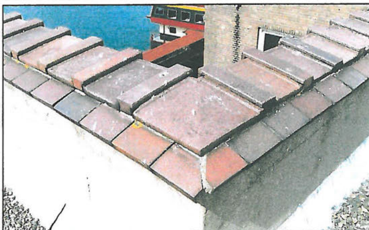
Afb. 18: De afgeronde borstwering van de rechtergevel. De betonnen ventilatiekap is van latere datum
